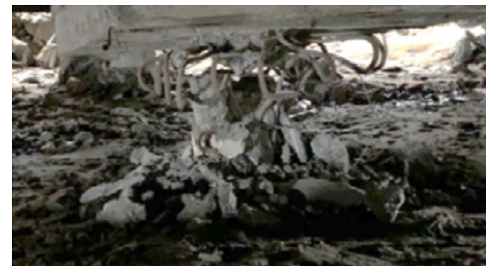
Рис. Разрушение железобетонных свайных опор фундамента резервуара
