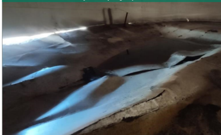
На фотографии внутренней части резервуара видно большое углубление, ставшее причиной разрушения пластин и перемещения внутренних колец внутрь, что привело к нарушению целостности в месте соединения с корпусом резервуара.
