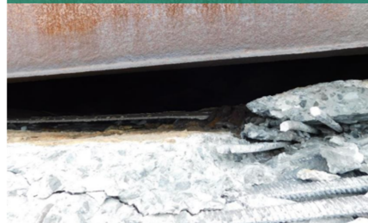
Разрыв корпуса резервуара, в месте где стенка была приварена к днищу
