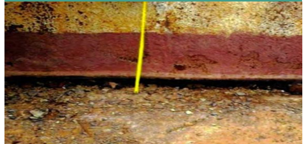
До аварии – Зазор между корпусом резервуара и фундаментом - 2018
