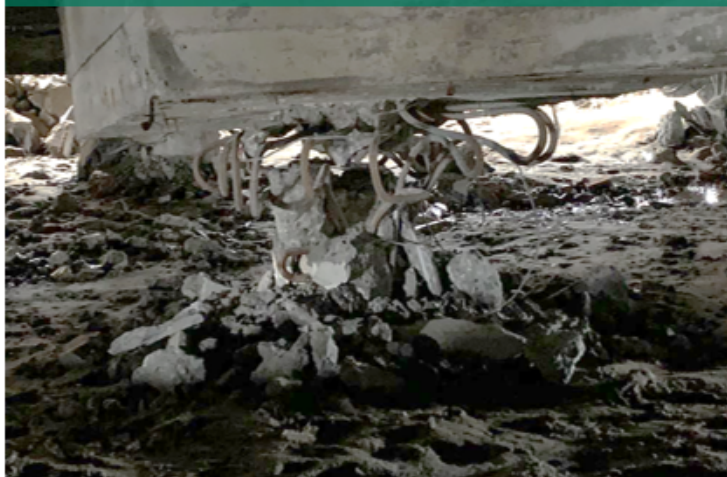
Разрушение железобетонных свайных опор фундамента резервуара
