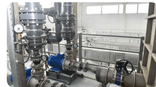
Очистные сооружения АО «НТЭК»
